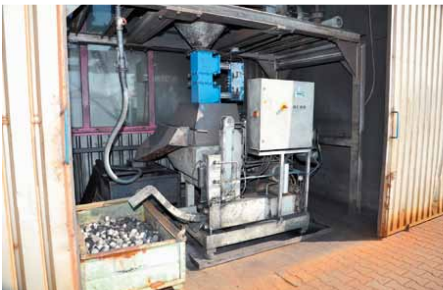
Bild 1: Seit rund zehn Jahren problemlos und automatisch im Einsatz: Die in einer Einhausung außen am Fertigungsgebäude der Frischhut GmbH platzierte RUF-Brikettierpresse
