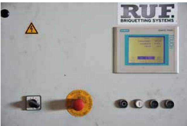
Bild 7: Einfache Bedienung: Die Brikettieranlage lässt sich über Tasten und einem Touchpanel steuern. Eine Lichtschranke im Sammeltrichter schaltet die Presse automatisch an und ab
