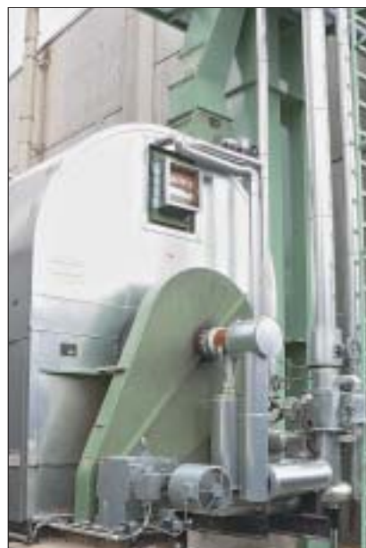
... ist der Kessel untergebracht, der den Röhrentrockner (im Bild) mit Wärme versorgt.
