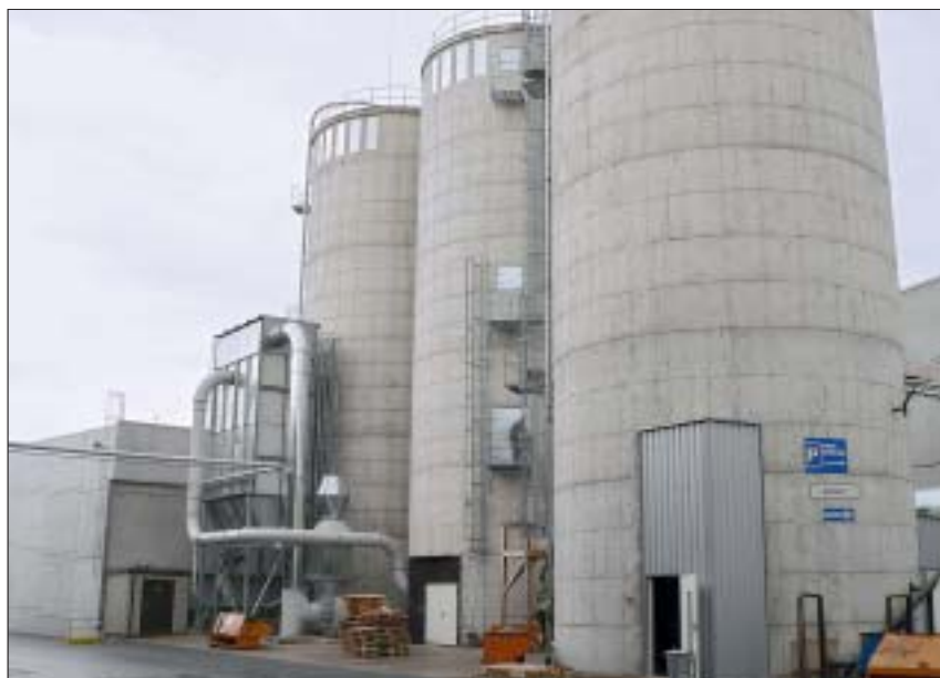
Außenansicht: Die beiden hinteren Silos dienen der Lagerung der getrockneten und nachzerkleinerten zugekauften Späne. Im zweiten Silo können sie mit Hobelspänen aus der eigenen Produktion gemischt werden. Im vorderen Silo ...
