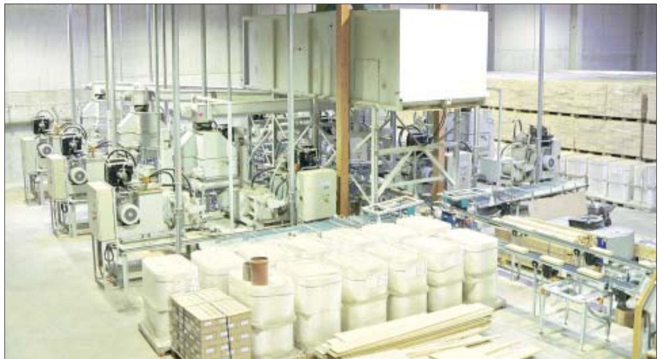
Insgesamt 12 Brikettpressen sind bereits installiert, der Zubau von acht weiteren ist vorgesehen.
