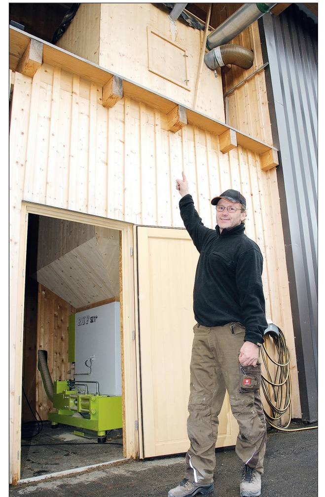
Um auch für größere Spänemengen gerüstet zu sein, installierte Hermann Schreder über dem Silo der Brikettierpresse zusätzlich einen Vorratsbehälter, der bis zu 12 m³ fasst
